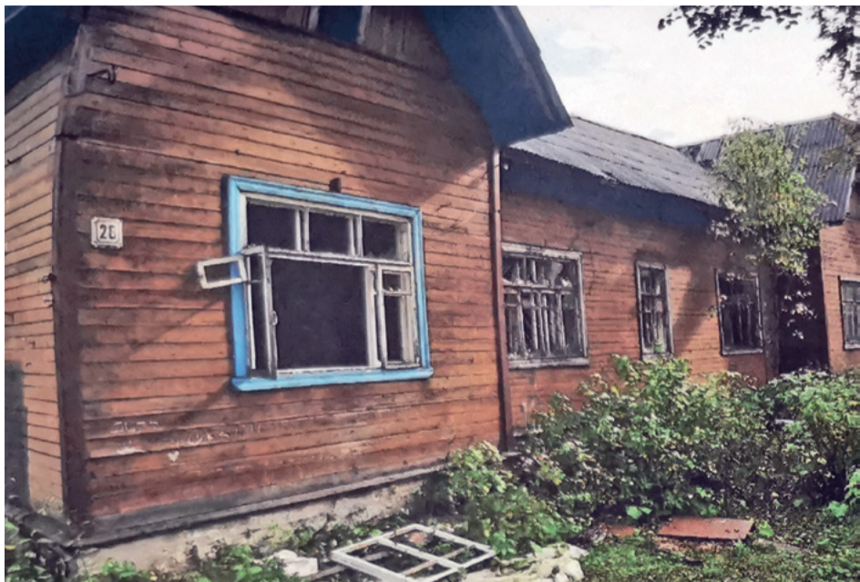
Дом после пожара
